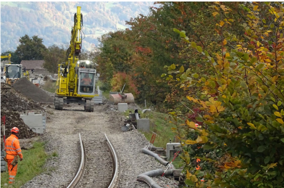
Es erfolgte der Aushub, das Entfernen der alten Trasse. Gleich zu Beginn wurden die neuen Mastfundamente gegossen.
