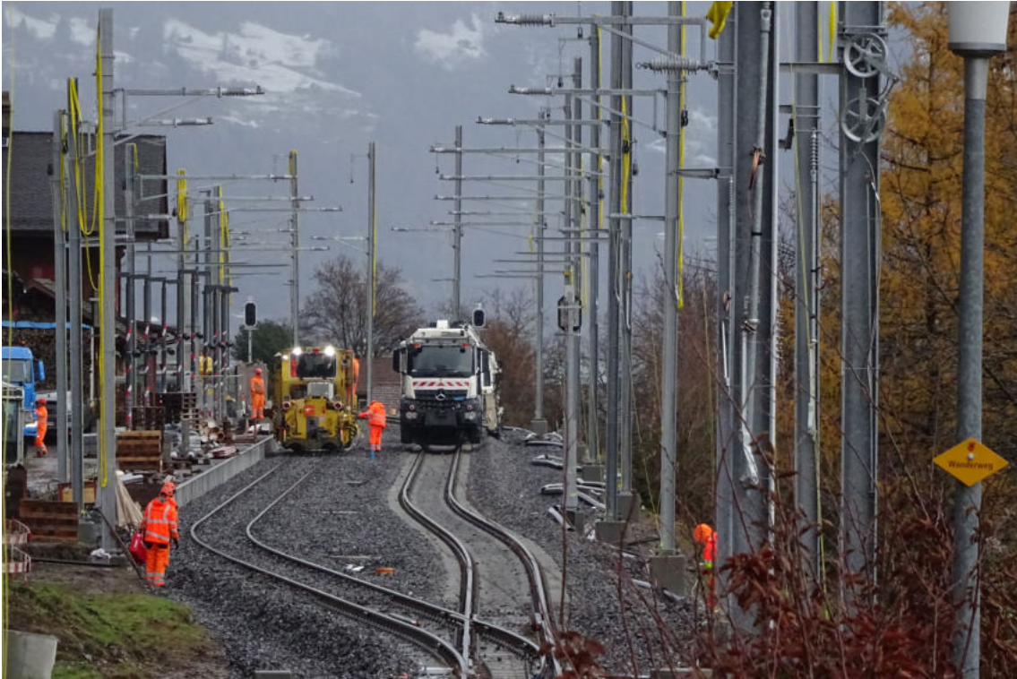
Kaum standen die Masten und noch während die Stopfmaschine ihre Arbeit beendete machten sich die Leitungsbauer an die Arbeit.
