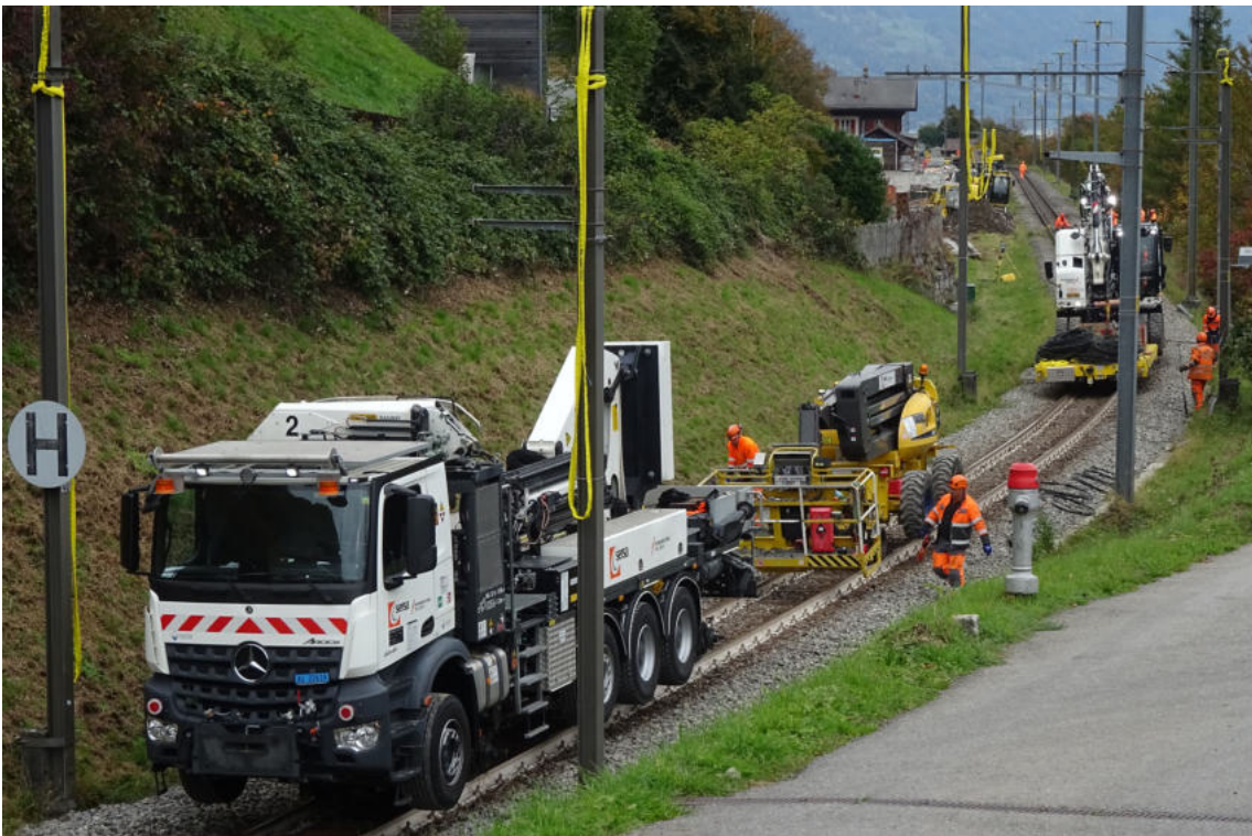
Dann wurden die Masten fürs 'Ziehen' vorbereitet. Der rechts vom Hydranten weigerte sich standhaft (und war danach immer 'störend im Bild')! Er verblieb und wurde integriert.
