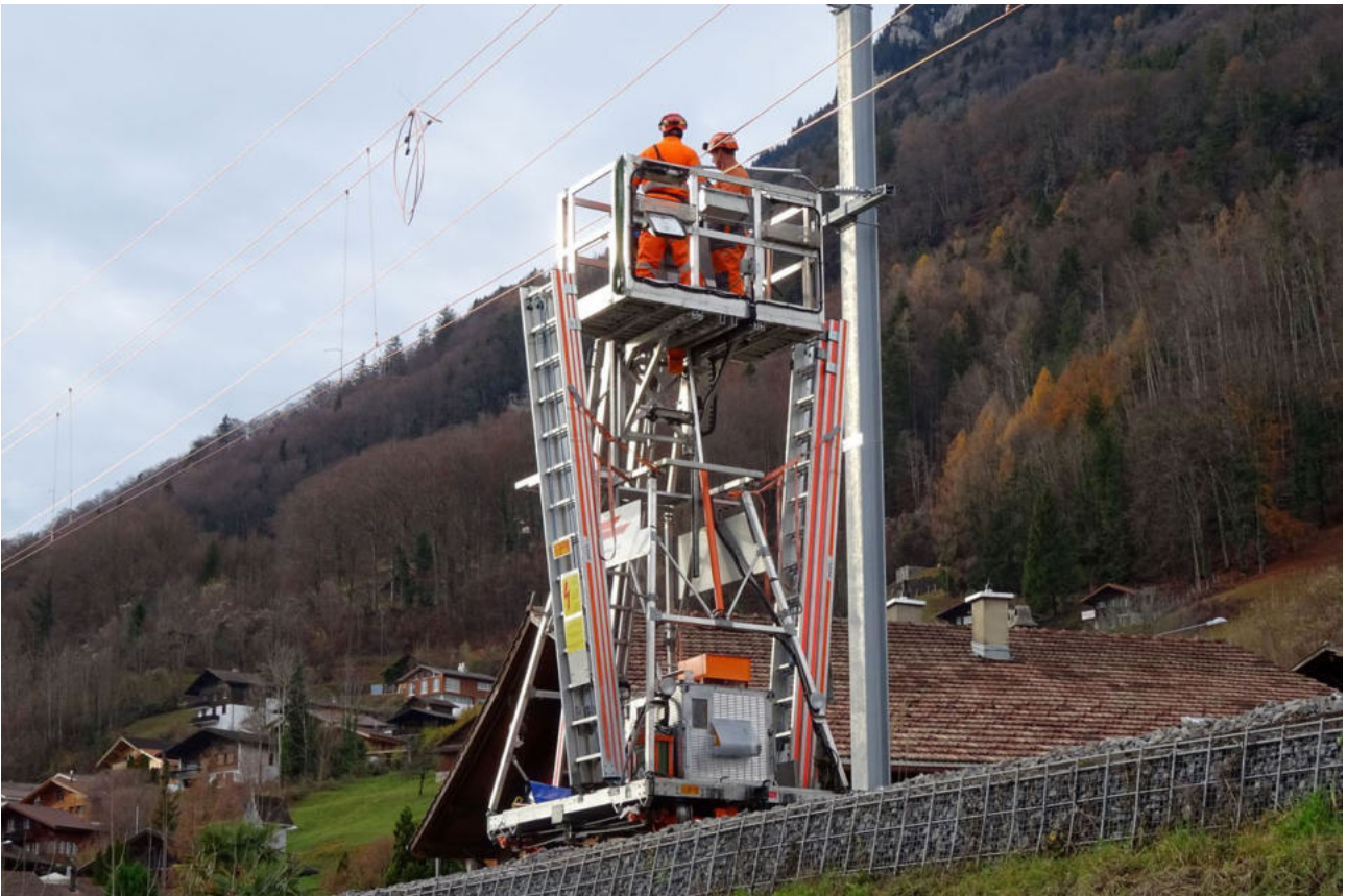
Eine Fahrleitungstrennstelle mit Verbindungskabel zum Verhindern von Funkenschlag.
