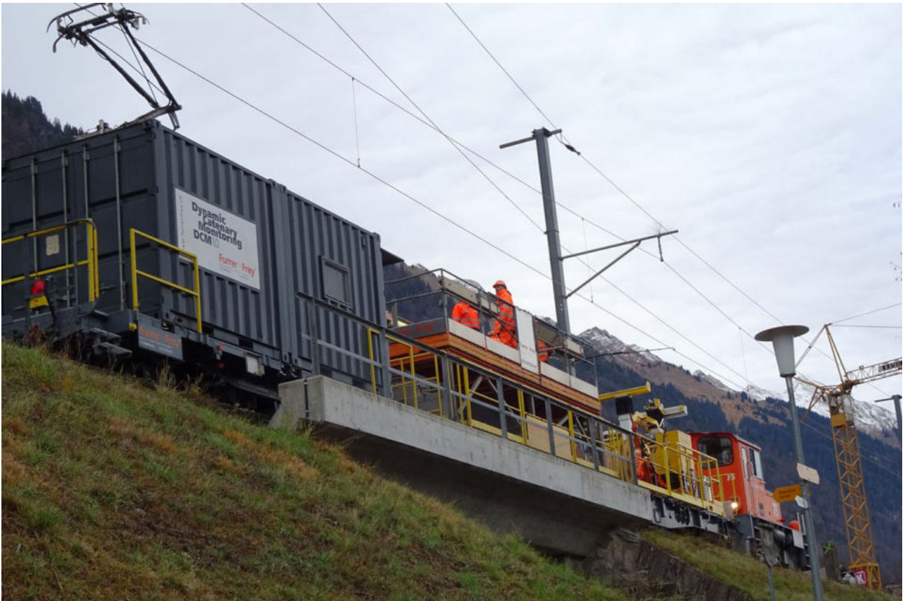
Der Messzug zur Kontrolle der (Führung der) Fahrleitung im Mätteli ...
